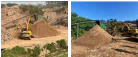
Figura 17- Central de Reciclagem de RCC em Barueri/SP.
